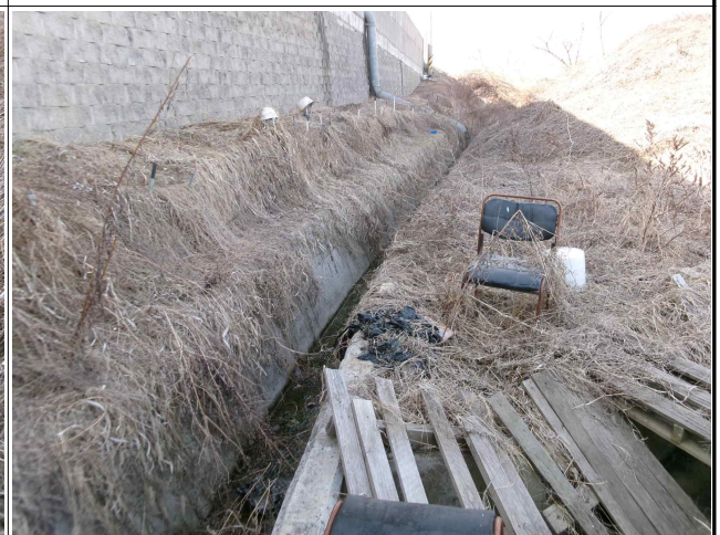
진안2지하차도 상부 배수로 정비필요
