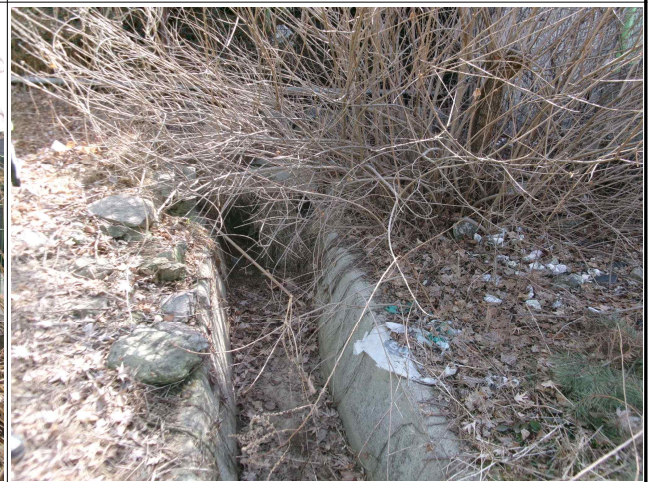
진안2지하차도 상부 배수로 정비필요
