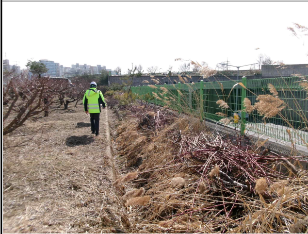
진안2지하차도 상부 배수로 정비필요
