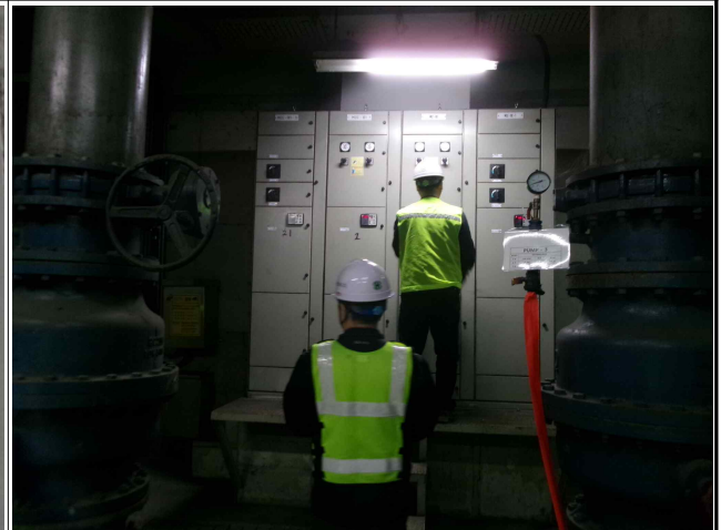
배수펌프 가동 여부 확인
