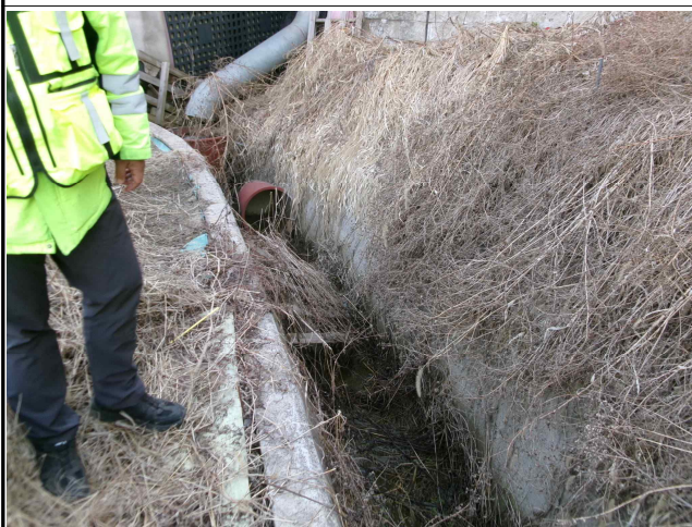
진안2지하차도 상부 배수로 정비필요
